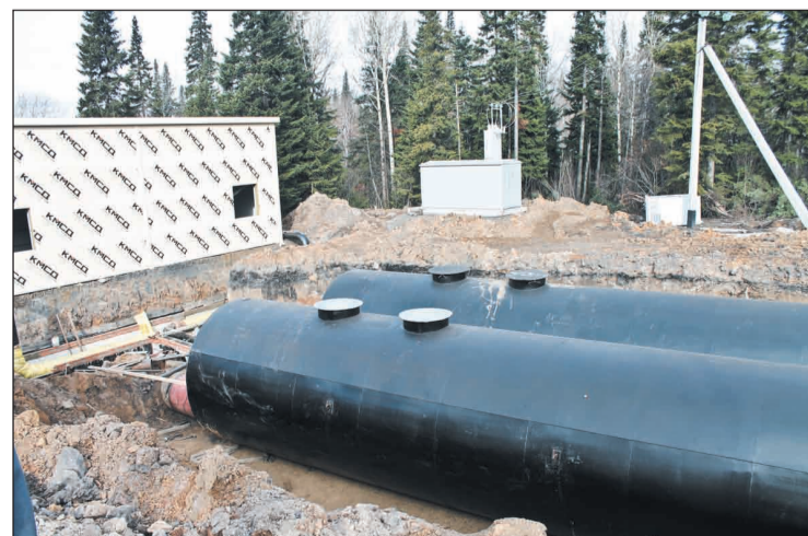
Резервуары для очистки шахтных вод шахты «Березовская»
